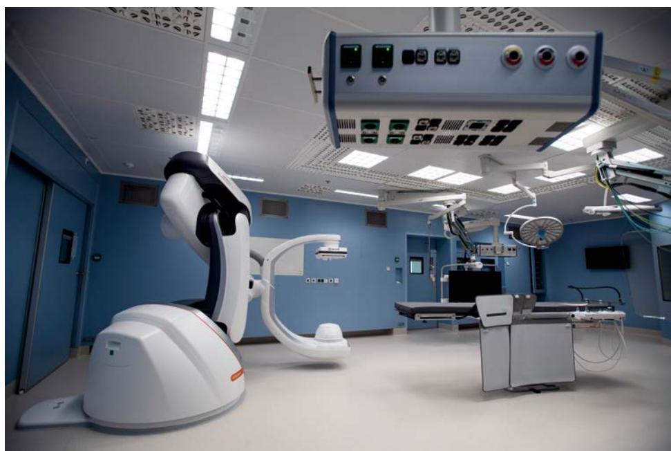
De zestien nieuwe OK's bevinden zich in twee compartimenten, die brandtechnisch van elkaar gescheiden zijn.
